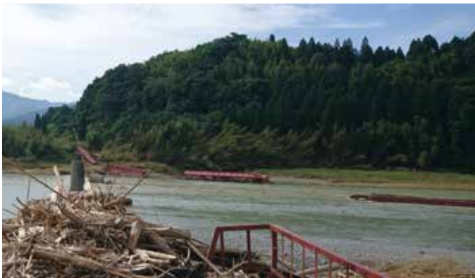
2020年7月球磨川水害 落橋した「球磨川第四橋梁(くま川鉄道)」(提供:角 哲也)
