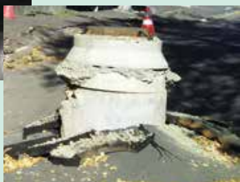
マンホール被害
