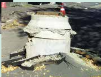
マンホール被害
